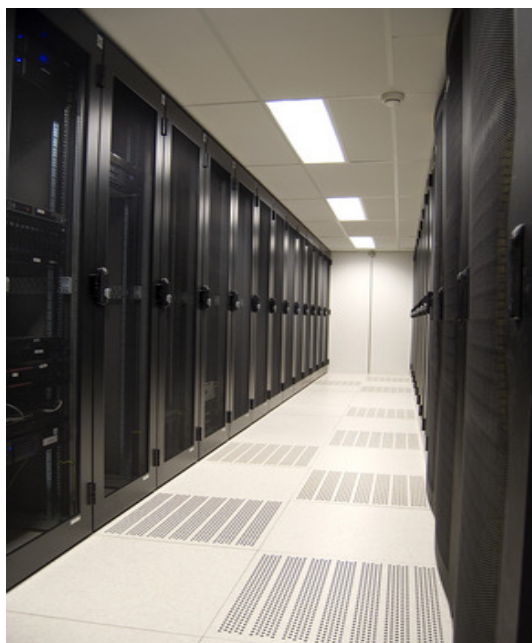
Deel van het datacenter
